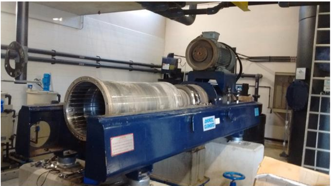
Figure 1: Révision générale des centrifugeuses
